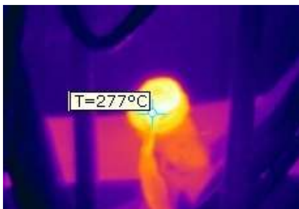
Рисунок 22. Пример обнаружения пожароопасного разогрева болтового контактного соединения
